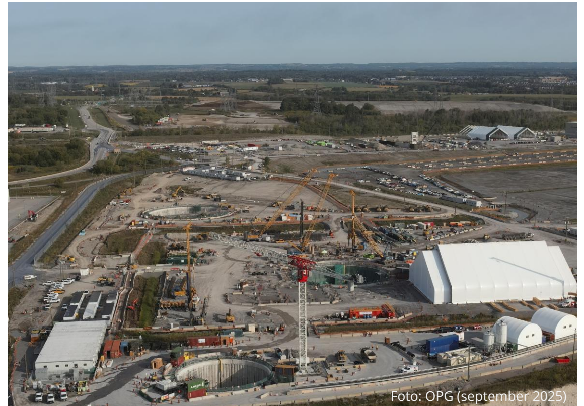
Darlington i Canada – første av fire reaktorer på 300 MW
