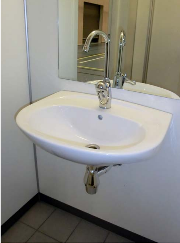
Servant med høy armatur – fungerer bra for fylling av drikkeflasker. Foto: Morten Roa
