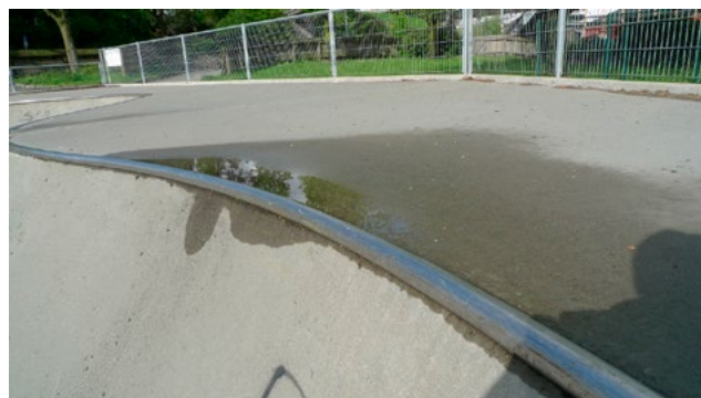
Vatn gjev dårleg veggrep. Avrenning bør prosjekterast godt. Foto: Fritjof Krogvold
