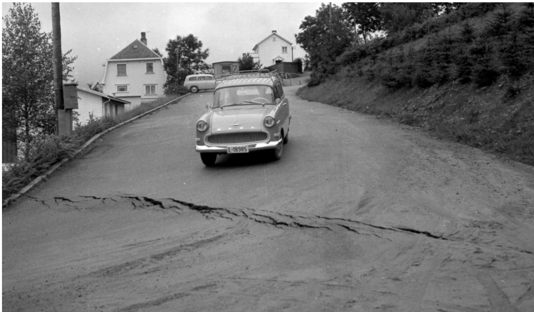
Store deler av Sandnes sentrum er bygd på leire. Nå har det store leirraset i Gjerdrum minnet sandnesbuen på bevegelsene i grunnen i august 1963, her i Chr. Kroghs gate like nedenfor Eidsvollgata og nåværende Trones bolig- og eldrecenter.
